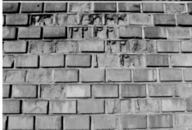
Slika 5: Poškodbe vgrajenih izdelkov
