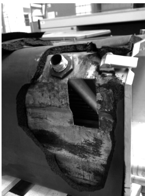
Figure 1: Corroded outer surface below the insulation Slika 1: Korodirana zunanja površina rezervoarja pod izolacijo
